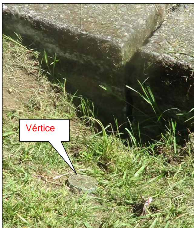
Foto 39: Vértice SHOA en mal estado.
