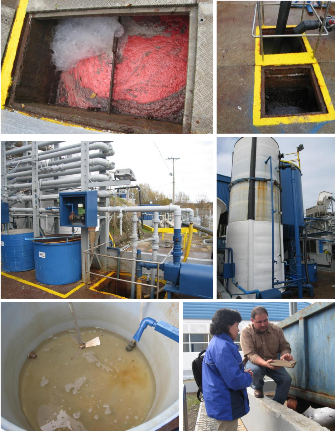
Figura 27. Fotos superiores: Proceso de separación de sólidos y grasa; fotos intermedias: floculación de materia orgánica y separación de líquidos y lodos; fotos inferiores: agua tratada y lodos compactados.
