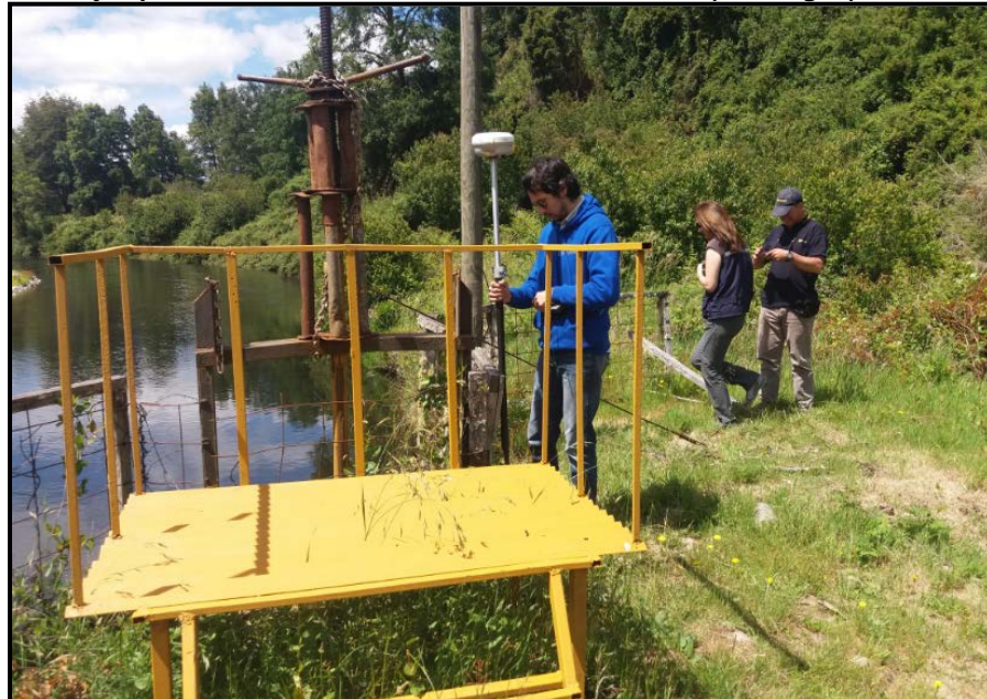
Figura N°32. Ejemplo Medición Bocatoma, Piscicultura Pichico (Los Lagos). Fuente: Ingeland.
